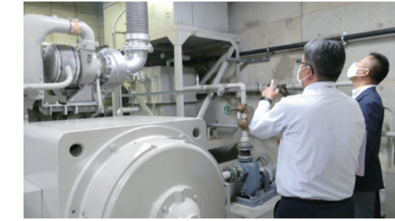
大阪府支部内の非常用発電システムをエネアースの担当者が確認
